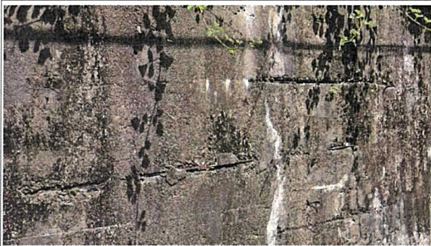
철근노출, 부식 및 콘크리트 박리발생
